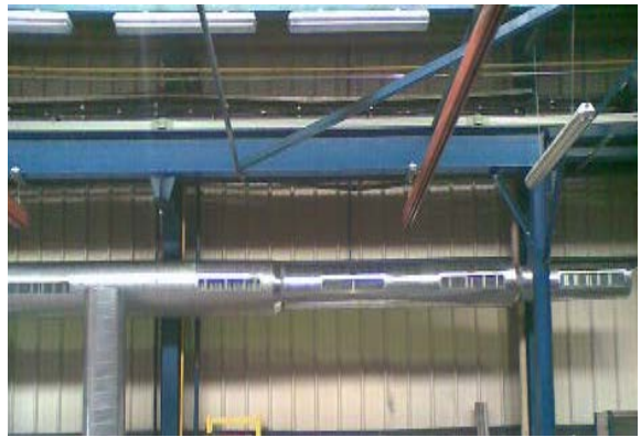
Celkový pohled do dílny na nasávací kanál, který je nainstalován pod jeřábovou dráhou, před boční stěnou.
