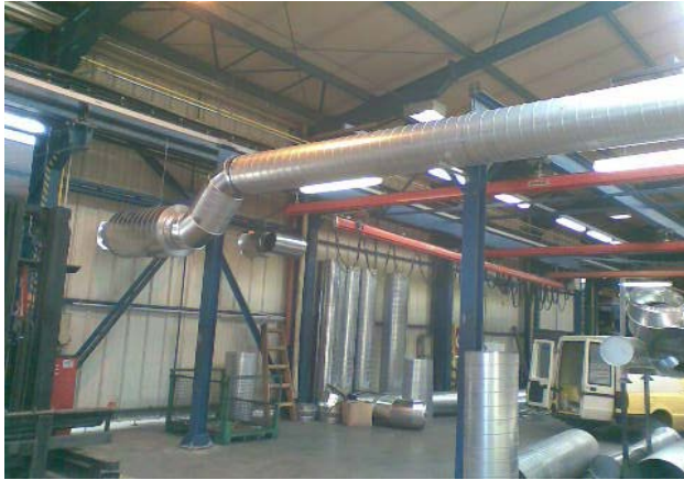
Detail výfukového kanálu, délka cca. 28 m.
