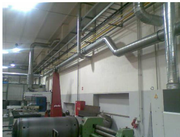
Obr. č. 4 Odsávání od svařovacího pracoviště – detail odsávacího kanálu a jeho propojení s odsávací jednotkou ESTA MOBEX F 56 BIA W3.
