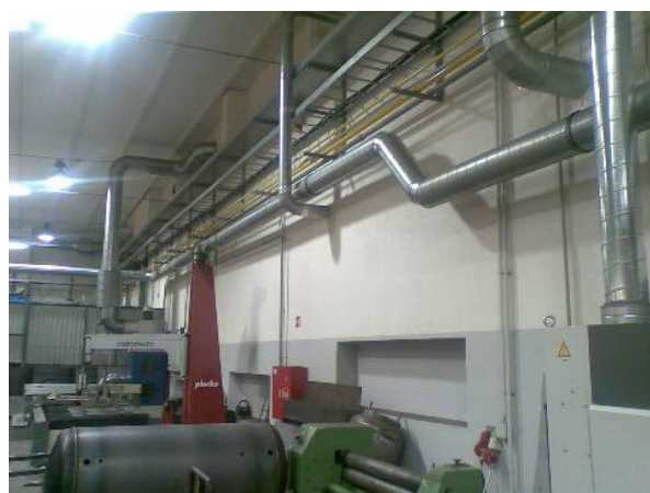
Obr. č. 4 Odsávání od svařovacího pracoviště – detail odsávacího kanálu a jeho propojení s odsávací jednotkou ESTA MOBEX F 56 BIA W3.
