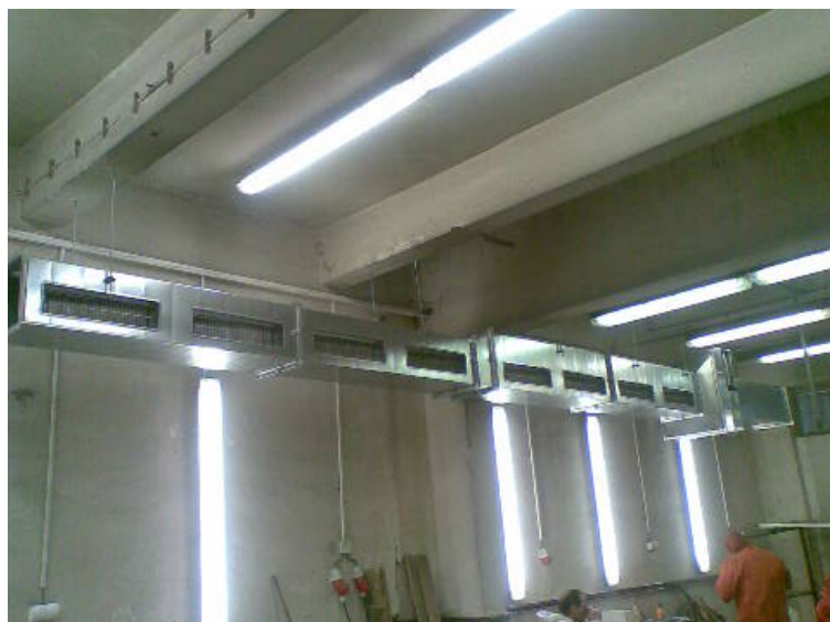
Výfukový kanál kompletní – nasměrování výfuku proti odsávacím stěnám.
