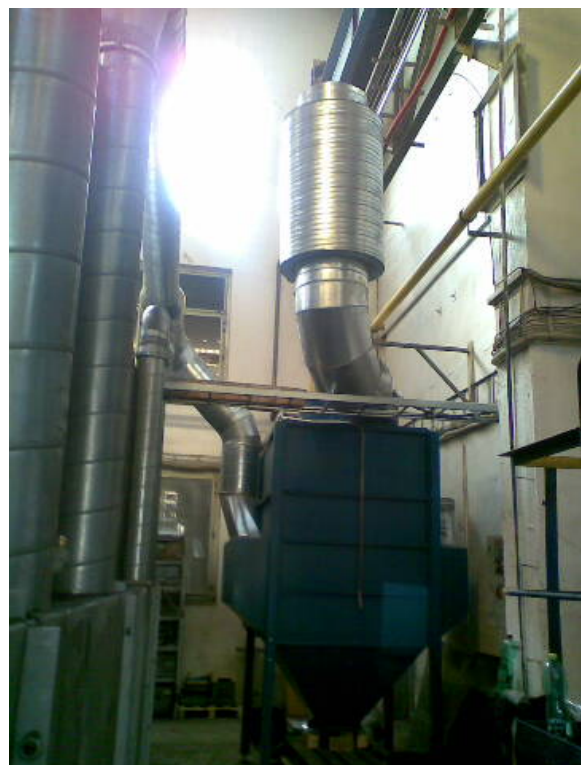
Pohled na tlumič hluku a potrubní systém.
