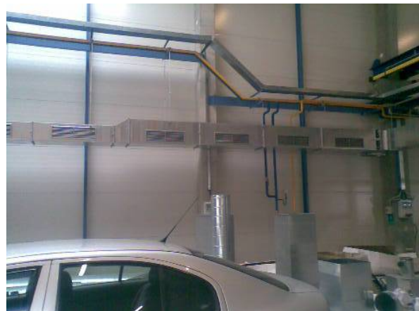
Výfukový kanál – detail, kvadratické potrubí 300 x 500 mm osazené výfukovými mřížkami pro návrat čistého vzduchu v zimním období zpět do výrobní haly.
