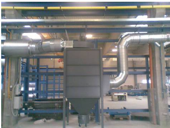
Centrální odsávací jednotka DUSTEX F - 144. Zprava nasávací kanál DN 450 mm, zleva výfukový kanál s tlumičem hluku.
