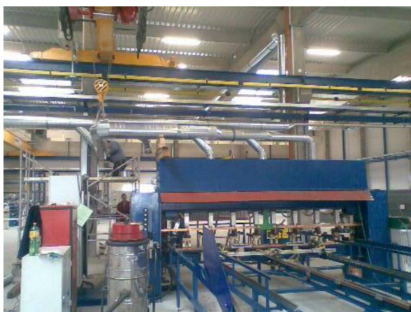
Výrobní stroj č. 1 napojený na odsávání. Rozměr digestoře cca. 4.000 x 1.000 mm
