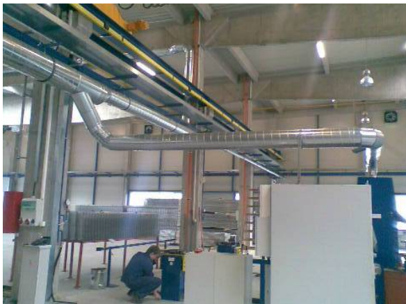
Potrubi systém, nasávací kanál – propojení na odsávanou digestoř zájmového stroje.
