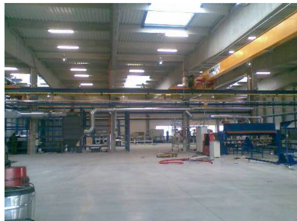
Pohled do výrobního prostoru – centrální odsávací modul DUSTEX F – 144 s přívodním nasávacím kanálem. Odsávací kapacita 14.000 m 3 /hod.
