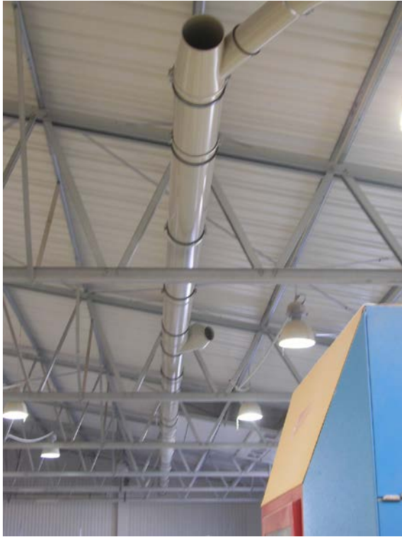
Potrubní větev. Ve výrobní hale jsou namontovány odsávací kanály – potrubí třídy II.
