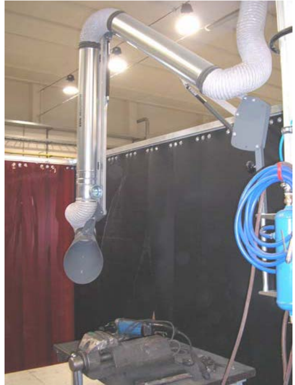
Pohled do svářecího boxu. Odsávací rameno – detail.
