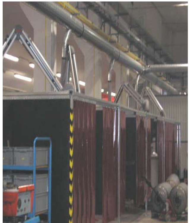
Celkový pohled do dílny, rozmístění strojů a potrubní rozvod.
