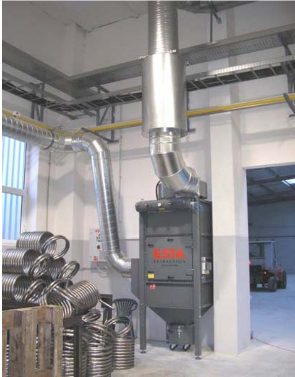
Celkový pohled do dílny na umístění filtru, Centrální odsávací jednotka ESTA DUSTEX F 84 – detail.
