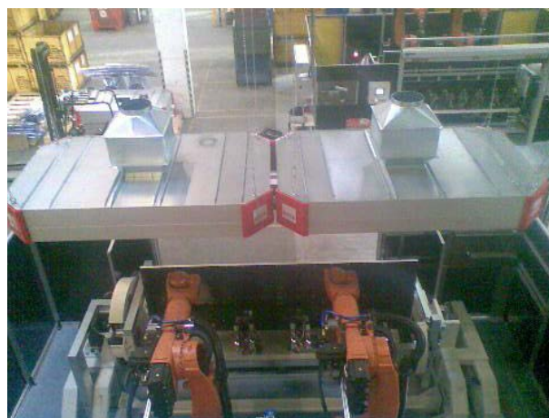
Pohled na nainstalované odsávací digestoře nad svařovacími roboty.
