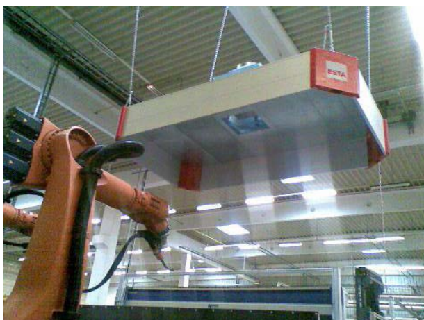
Odsávání od svařovacího robota, detail odsávací digestoře ESTA 3.000 x 1.500 mm.
