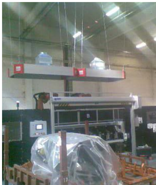
Celkový pohled do haly na nainstalované odsávací digestoře.
