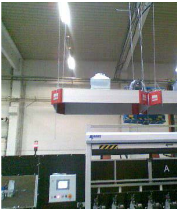
Další pohled na nainstalované odsávací digestoře nad svařovacími roboty.
