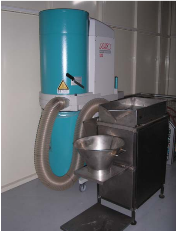
Celkový pohled na pracoviště. Detail separátoru a jeho propojení s mobilní odsávací jednotkou AL-KO MOBIL POWER JET 120.
