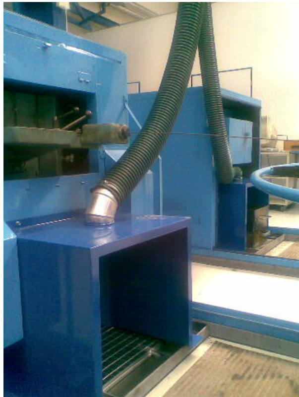
Napojení odsávání na výrobní stroj – detail.
