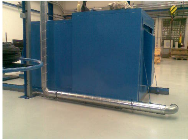
Napojení zájmového stroje – detail.
