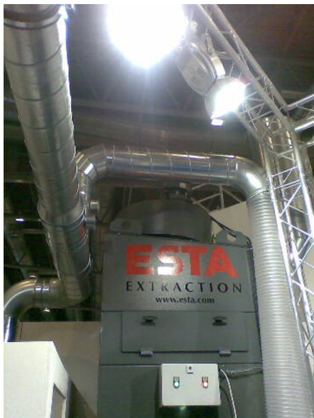
Pohled na odsávací potrubí.
