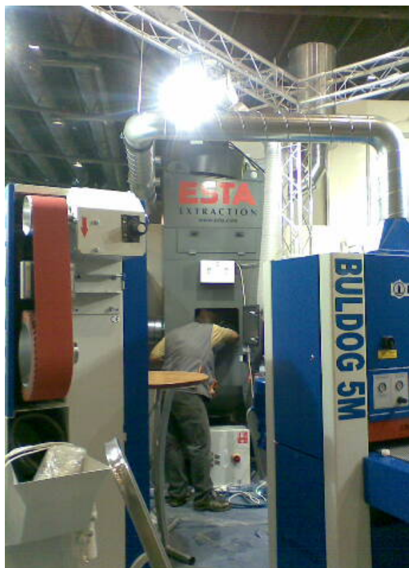
Vodní odlučovač – spojení se zájmovým strojem - detail.
