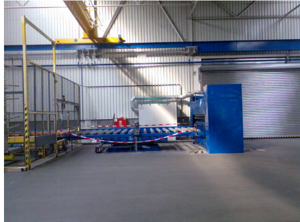
Výrobní hala. V jedné z částí je umístěna technologie na drcení skla. Celkový pohled na drtič a odsávací modul AL-KO MOBIL POWER JET 250.
