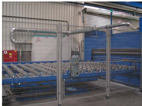
Odsávání od drtiče kazových tabulí skla. Odsávání pomocí AL-KO MOBIL POWER JET 250.
