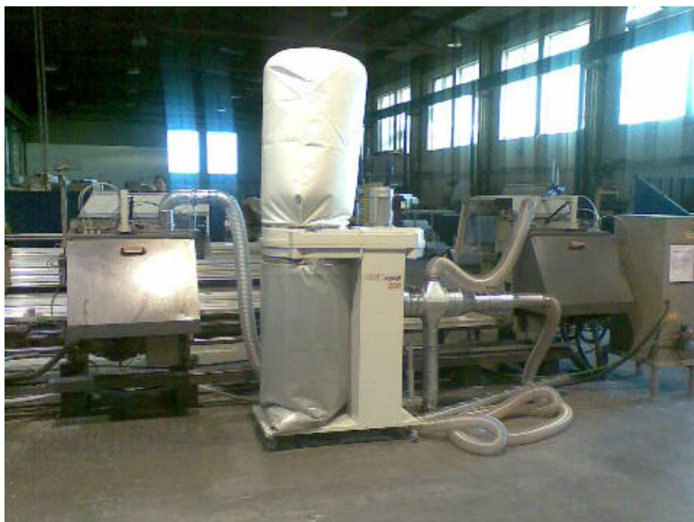
Celkový pohled na výrobní linku. Odsavač je napojen na dvě nářezové pily pomocí flexibilních PU hadic. Součástí odsávacího kompletu je úklidový set.
