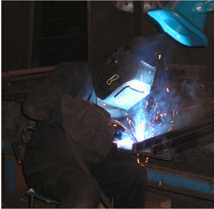
Detail svářecího pracoviště. Odsávání dýmů plastovým dymníkem.
