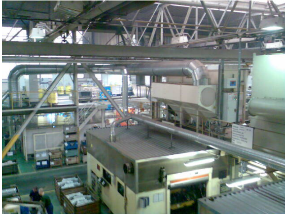
Napojení svařovací kabiny – detailní pohled na potrubní větév. Hlavní přívod do centrálního odsávání.
