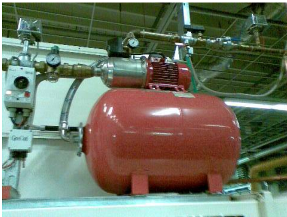
Zhášecí zařízení GRECON – detail. Nádoba s čerpadlem a ovládáním jednotlivých ventilů.
