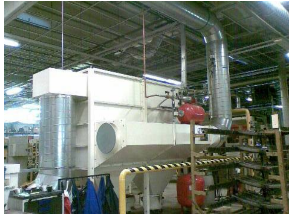
Centrální odsávací modul ESTA DUSTEX F – 567. Dvě červené oválné nádoby jsou součástí zhášecího zařízení GRECON. Při zaznamenání jiskry, nebo žhavé částice v potrubním kanálu dochází k automatickému zahašení.
