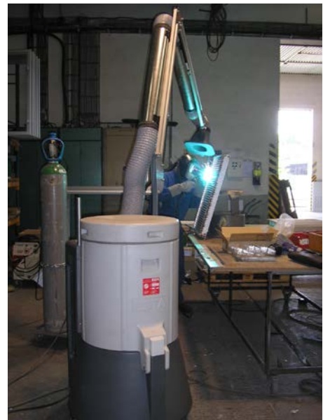
ESTA SRF K 15, odsávání od bodového svařování hliníku.
