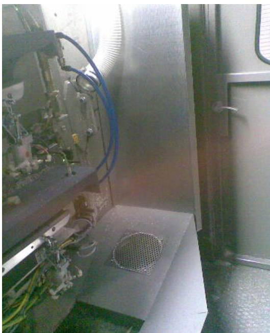
Úprava kabiny robotizovaného obráběcího pracoviště - spodní odsávací segment – detail.
