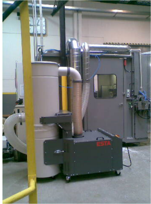
Celkový pohled na pracoviště. Propojení kabiny robotizovaného pracoviště s odsávacím zařízením ESTA DUSTOMAT 67 pomocí ocelového SPIRO potrubí.
