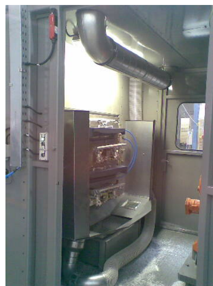
Odsávání z kabiny – detail.
