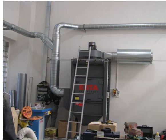
Montáž centrálního, filtračního modulu ESTA DUSTEX F - 42 se speciálními filtračními polyesterovými patronami.
