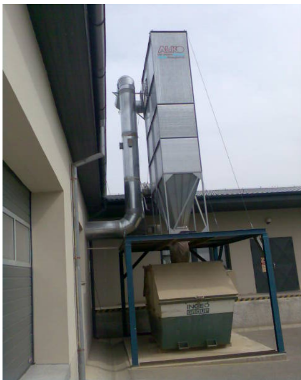
AL-KO ECO JET s vyhrnovacím ústrojím ZRS 960. Propojení s odsávacím kanálem. Zařízení je umístěno na ocelové podestě, pod kterou je velkoobjemový kontejner.
